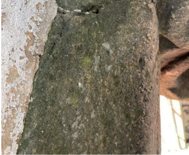
Imagen 53.- Manchas de algas sobre elementos pétreos.
