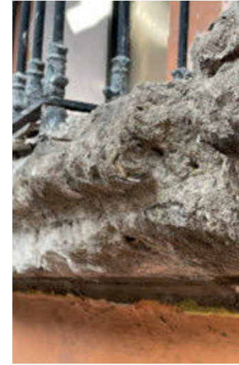
Imagen 89.- Disgregación de cantera en cornisa.
