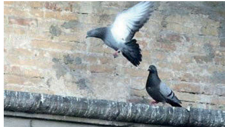
Imagen 84.- Corrosión causada por palomas en cornisa.
