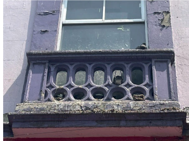
Imagen 83.- Presencia de excretas de palomas en balcón de fachada.
