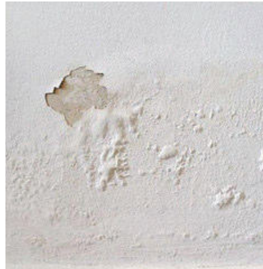
Imagen 64.- Humedad puntual en muros.
