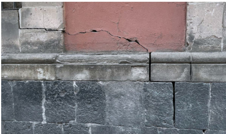
Imagen 72.- Grietas en muro y rodapié.
