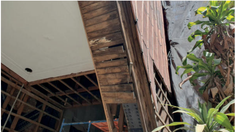
Imagen 52.- Madera deteriorada, causado por hongos.
