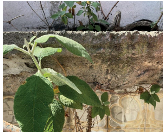
Imagen 56.- Flora parásita en muro y cornisa.
