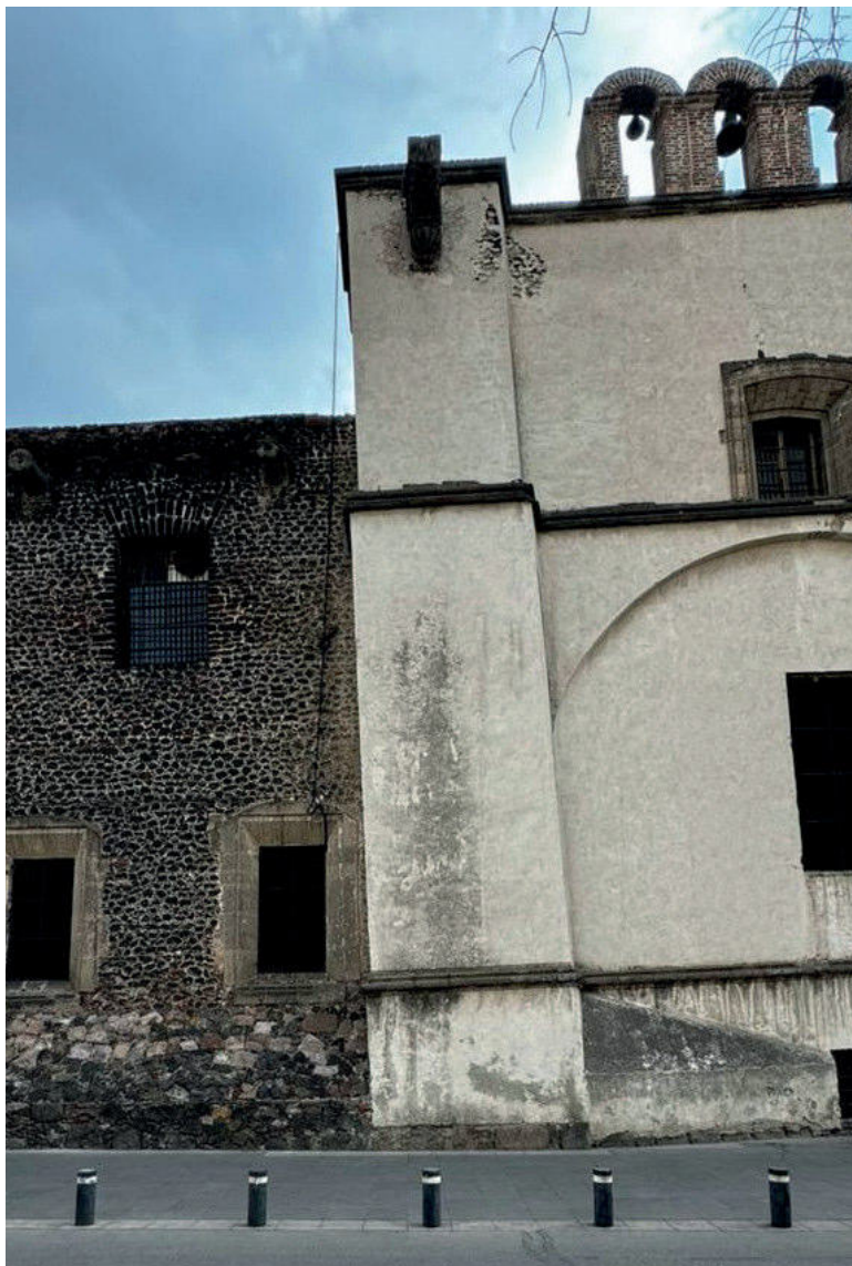
Imagen 69.- Deformación en fachada
