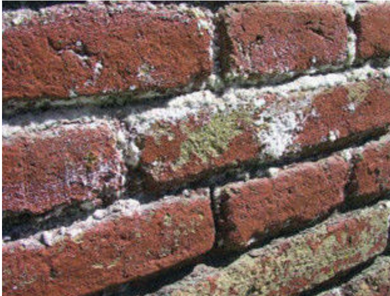
Imagen 81.- Detalles de eflorescencia en muros de distintos materiales.
