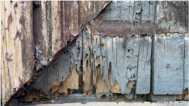
Imagen 51 .- Deterioro en puerta de madera causado por insectos xilófagos.
