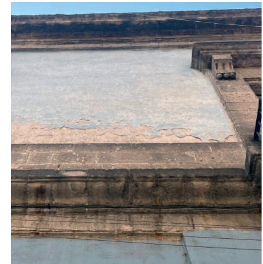
Imagen 68.- Suciedad en cornisa
