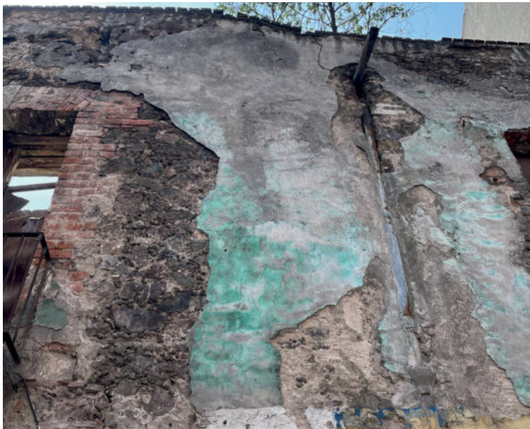
Imagen 78.- Desprendimiento de aplanado en muro de fachada.
