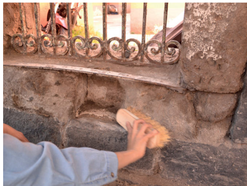
Imagen 122.- Limpieza de marcos de ventanas que presentan disgregación.
