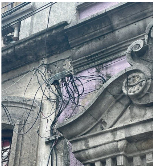
Imágenes 57 y 58.- Instalaciones adosadas en desuso.
