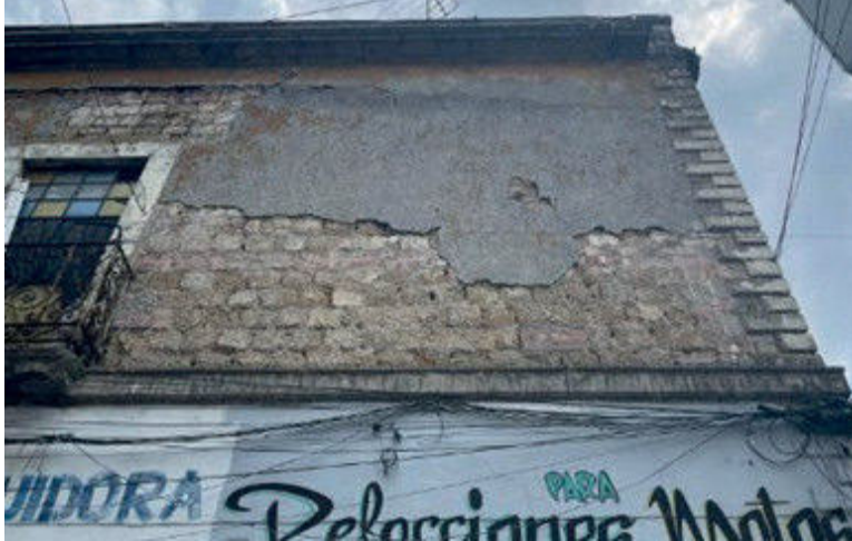
Imagen 77.- Desprendimiento de aplanado en muro de fachada.
