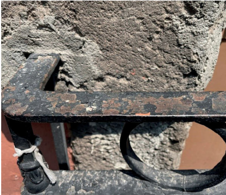
Imagen 85- Oxidación en barandal de herrería.
