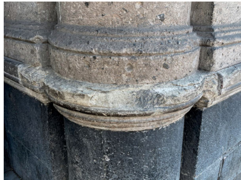
Imagen 80.- Erosión mecánica en pilastra de cantera.
