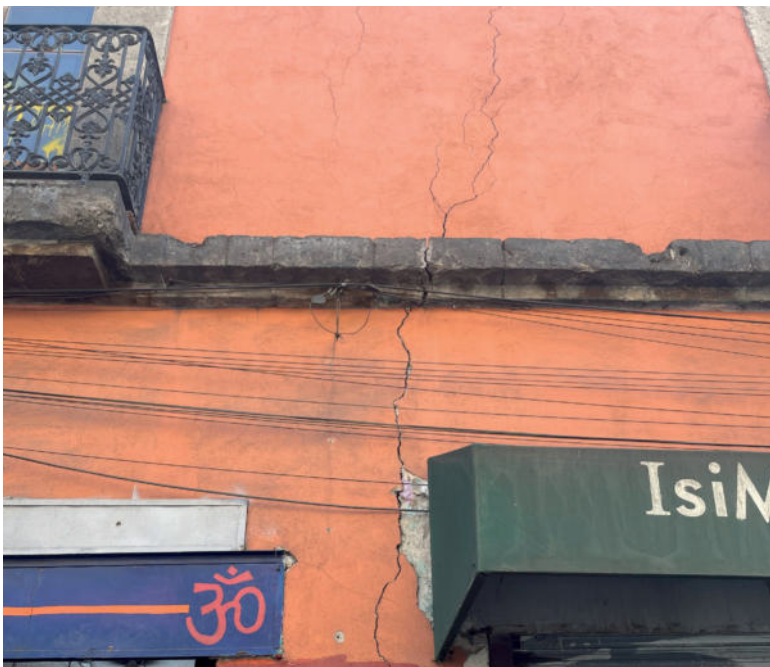
Imagen 73.- Grietas en muro.
