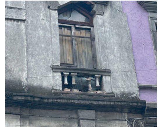
Imagen 67.- Suciedad en cornisa
