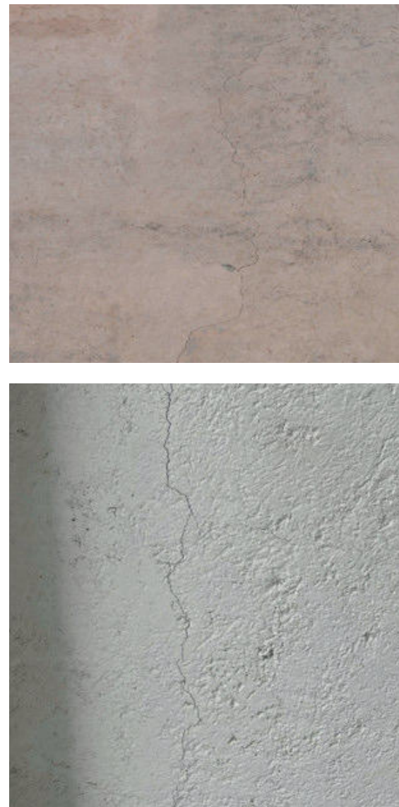
Imagen 70 y 71.- Fisura en aplanados
