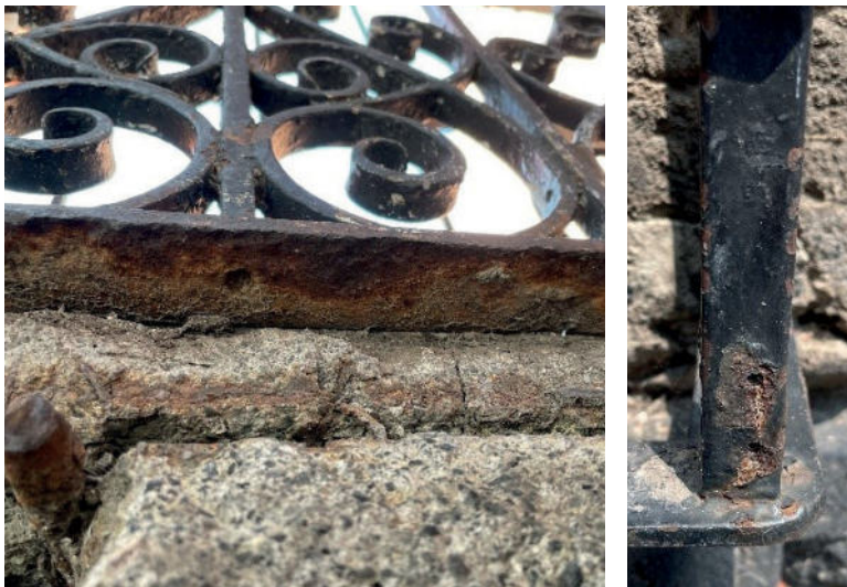
Imágenes 86 y 87.- Oxidación en elementos metálicos de balcones.
