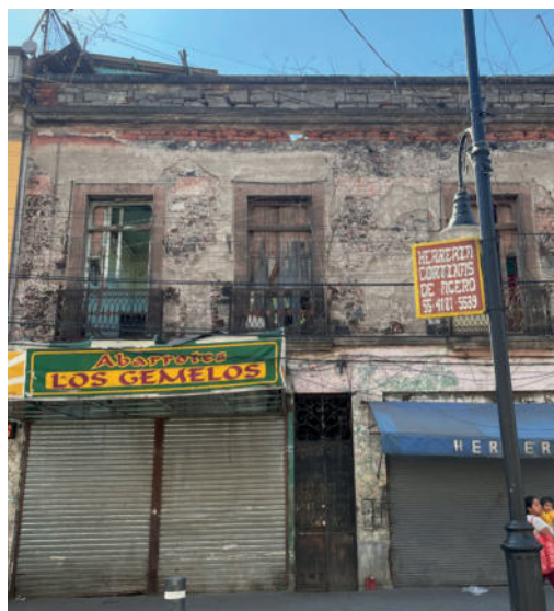
Imagen 59.- Pintura vinílica en rodapié de cantera. Imagen 60.- Toldo fuera de norma en fachada.
