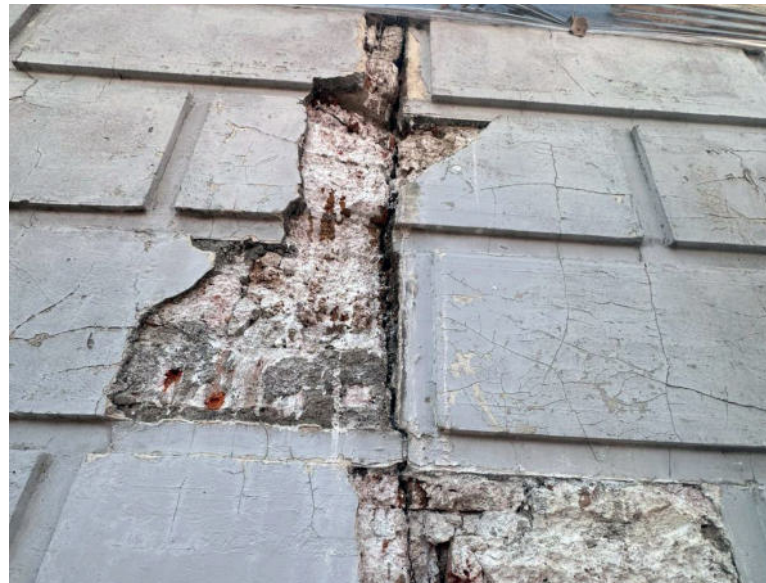
Imagen 74.- Fracturas en muro y elementos decorativos.
