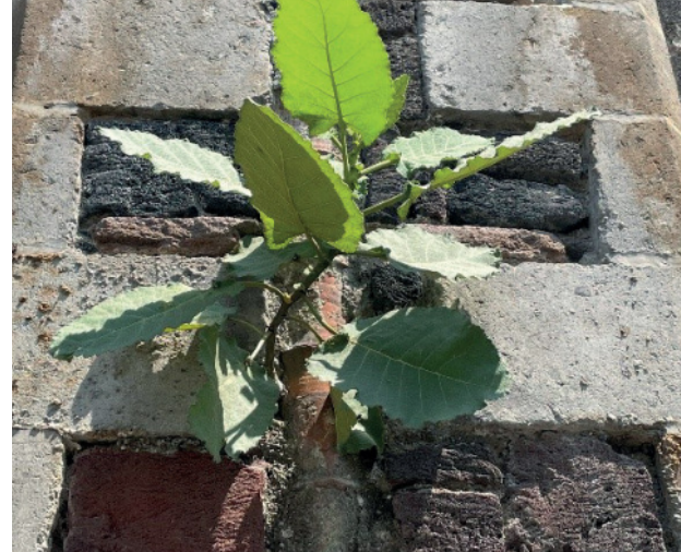
Imagen 55.- Flora parásita en muro.
