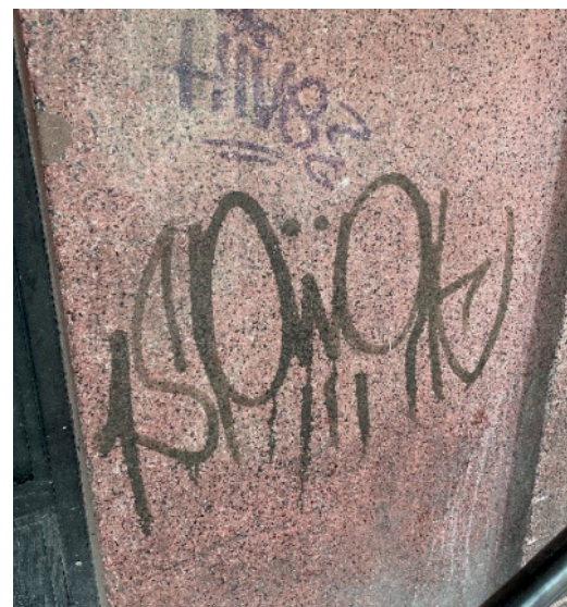
Imágenes 61 y 62.- Deterioros en fachadas por el uso de clavos y por graffitis.
