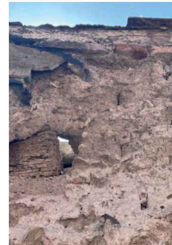
Imagen 90.- Disgregación en muro de adobe.
