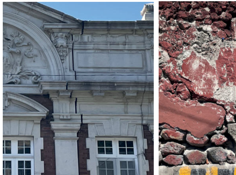
Imágenes 75 y 76.- Ausencia de aplanado y fractura en muro.
