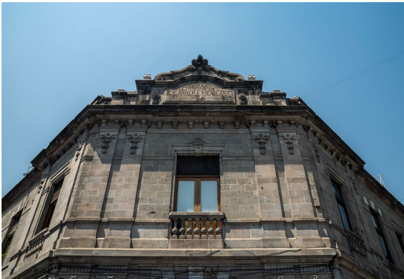
Edificio en Plaza de San Juan, reconstrucción de la Cigarrera El Buen Tono
