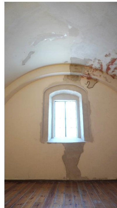
Figura 42. Aplanados en muros grietas de Coro..
