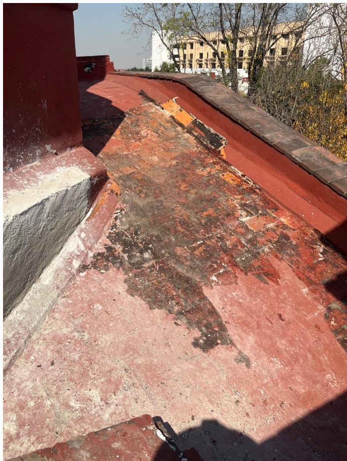
Figura 151. Estado de cubierta norte previo a intervención
