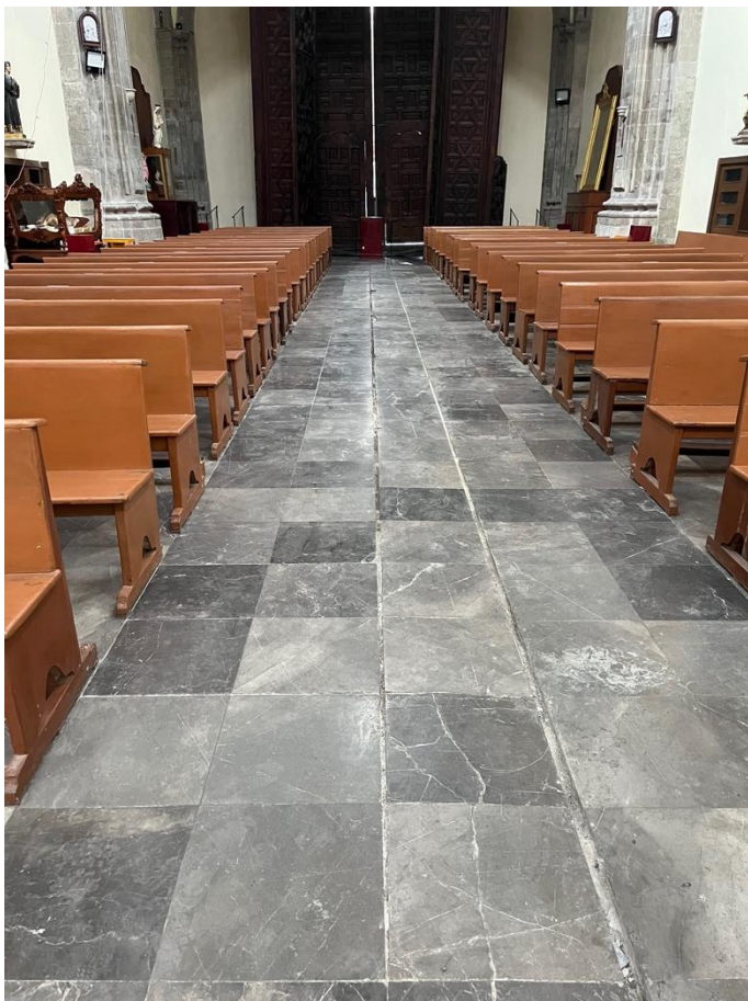
Figura 8. Estado del piso en la nave principal previo a intervención
