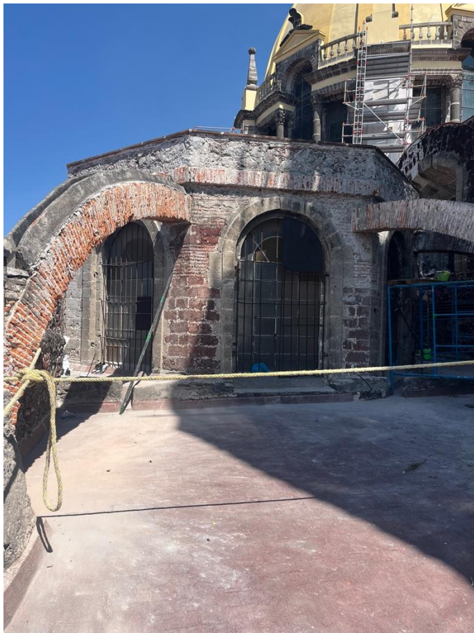
Figura 120. Estado del tambor
