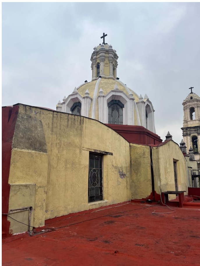
Figura 137. Estado de fachada en azotea previo a intervención
