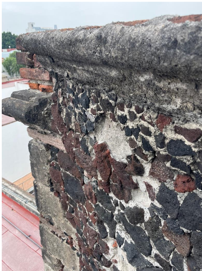
Figura 184. Estado de mampostería y cornisa previo a intervención
