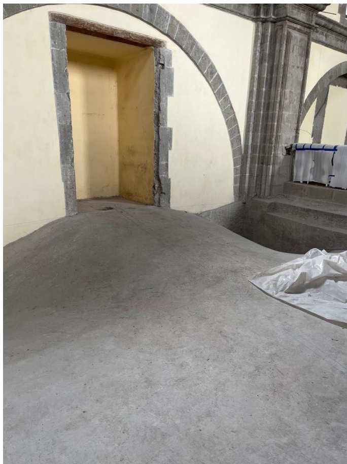
Figura 2. Estado del coro previo a intervención
