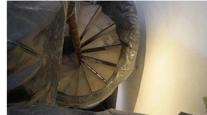
Figura 36. Protección de escalera helicoidal.
