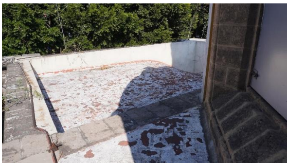
Figura 85. Estado inicial de bóvedas.
