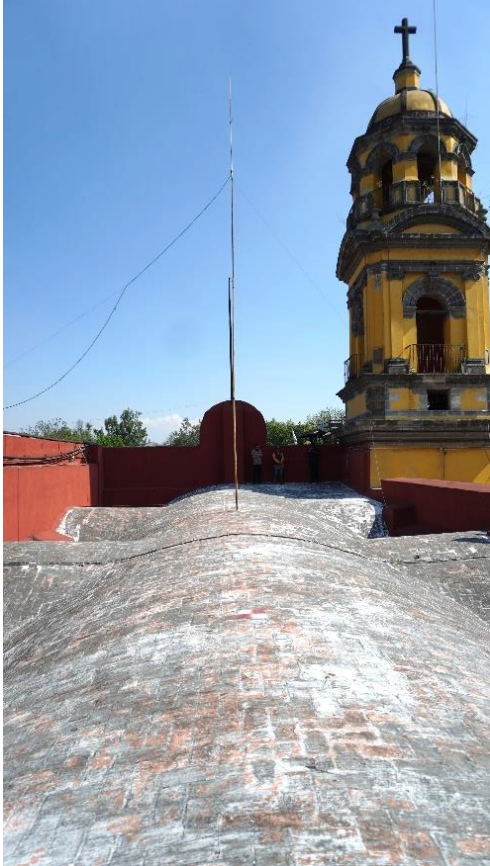
Figura 2. Estado Inicial de las Bóvedas de la Nave Principal.
