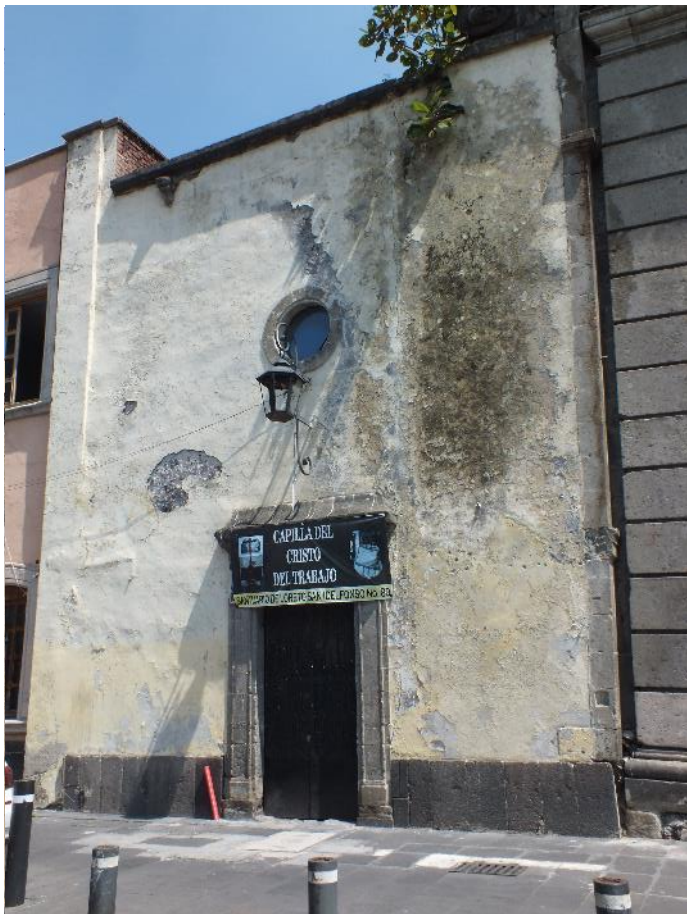
Figura 75. Estado de la fachada de la capilla
