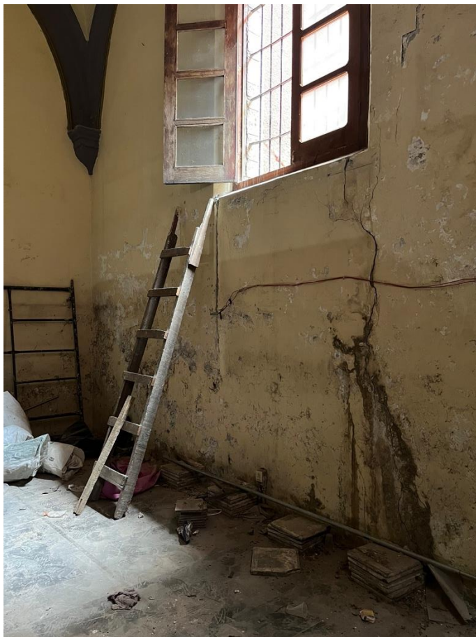
Figura 65. Estado de la sacristía
