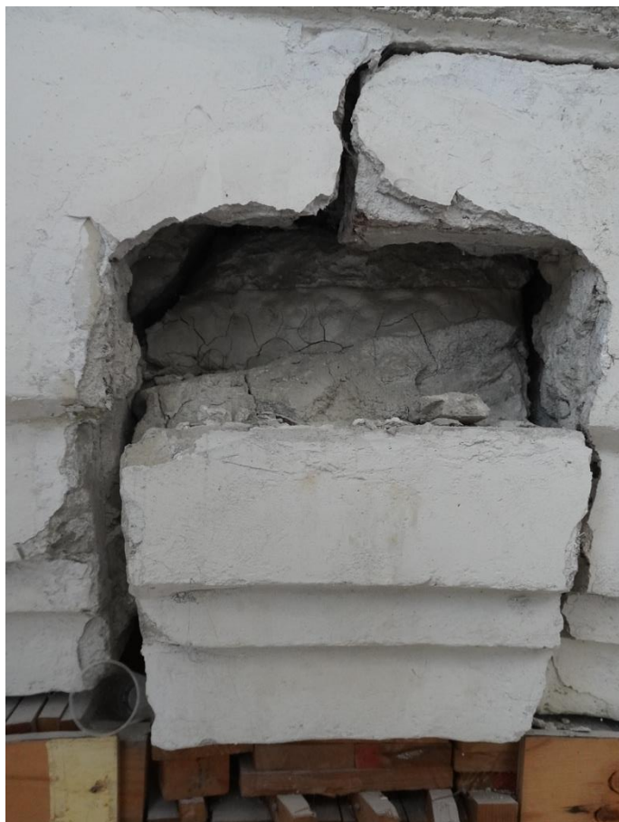
Figura 107. Estado de dovela en arco toral
