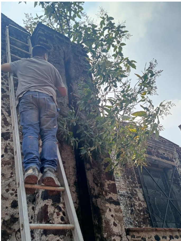
Figura 141. Estado de flora parásita en fachada norte
