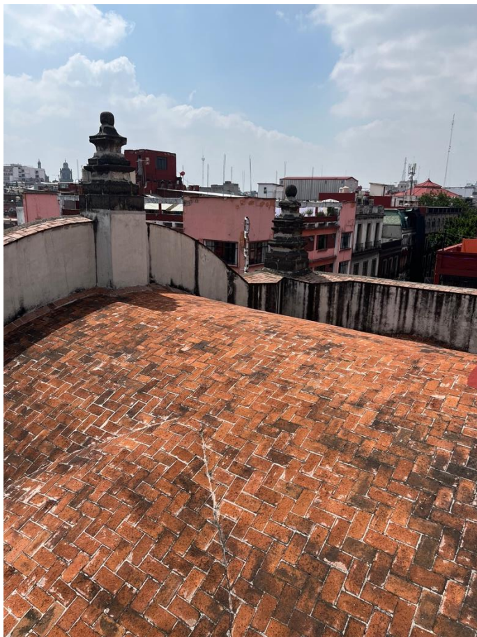
Figura 205. Estado de cubierta previo a colocación de impermeabilizante
