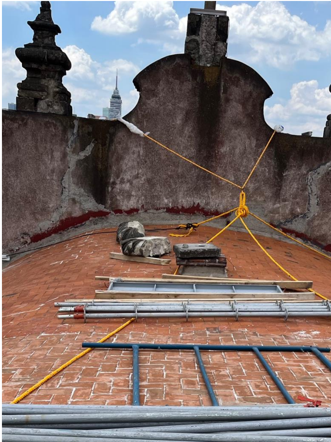
Figura 12. Estado del paño interior de la fachada principal (pretil)
