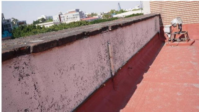
Figura 14. Estado inicial de pretilos.
