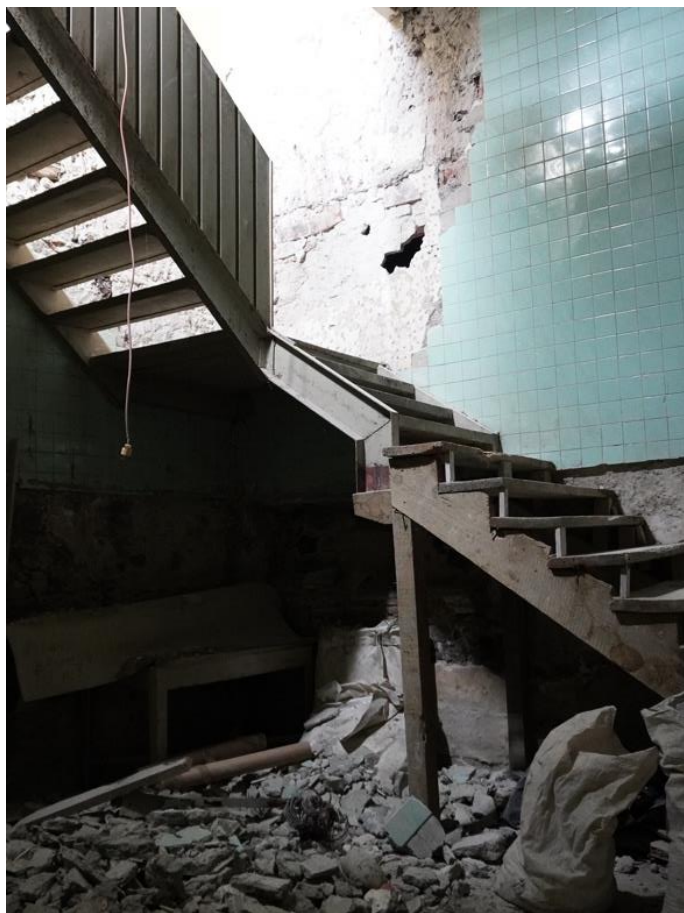
Figura 62. Estado del cubo de escaleras
