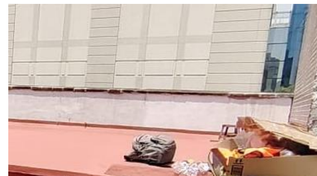
Figura 16. Estado final de pretilos.
