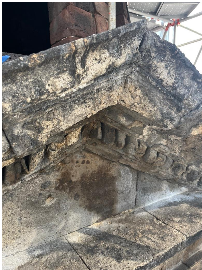
Figura 91. Estado de elementos de cantera en torres campanario
