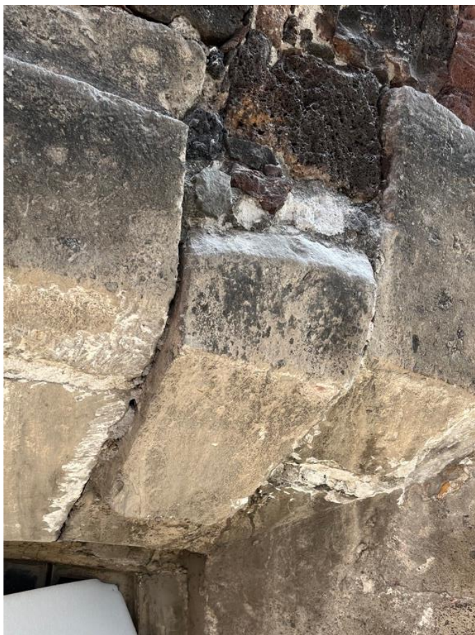
Figura 198. Estado de dovela
