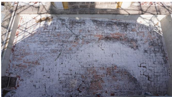
Figura 88. Estado inicial de extradós de bóvedas Capilla de Dolores.
