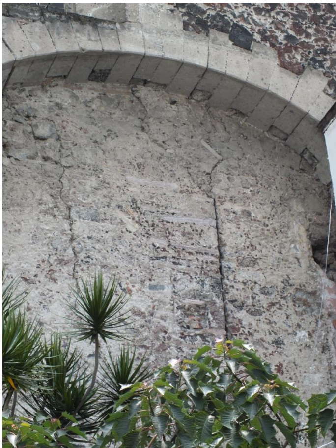
Figura 192. Estado de fachada poniente previo a intervención
