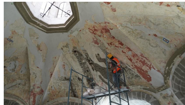
Figura 8. Consolidación de grietas..
