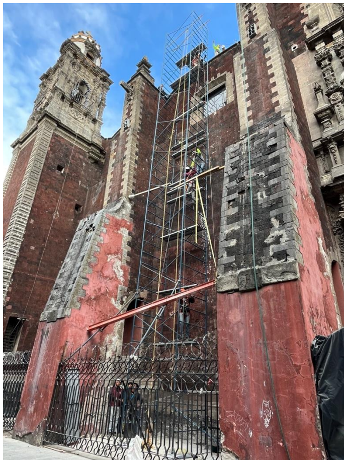
Figura 52. Estado de los contrafuertes en fachada sur
