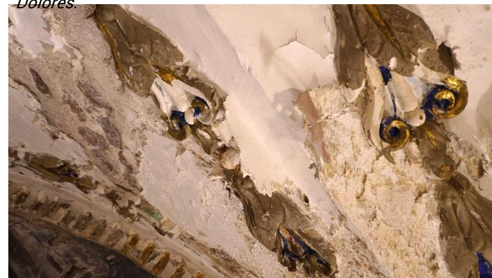
Figura 74 .Estado Inicial de intradós de bóveda en Capilla de Dolores.
