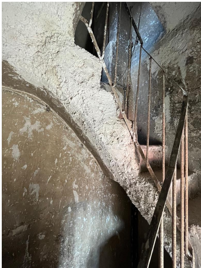
Figura 25. Estado del interior de la torre
