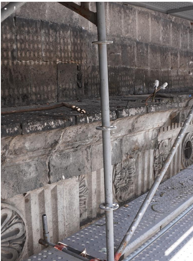
Figura 81. Estado de elementos de cantera en fachada principal
