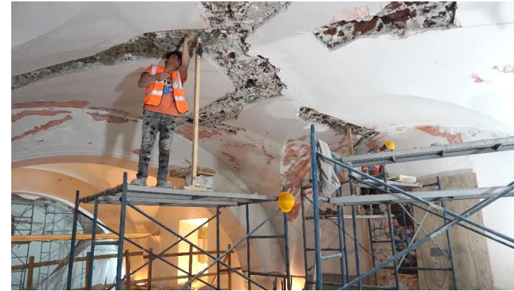
Figura 27. Consolidación de grietas..
