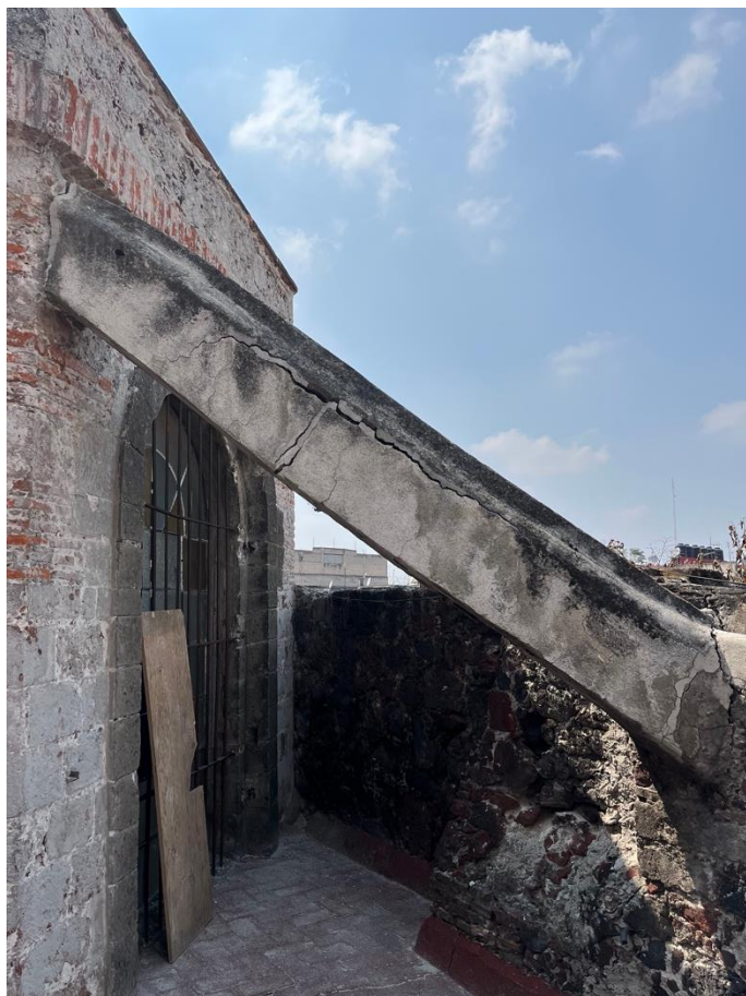
Figura 123. Estado del arco botarel
