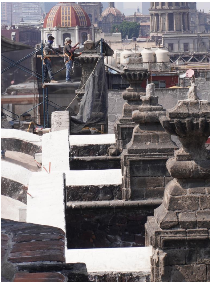
Figura 55. Estado de los pináculos previo a la intervención
