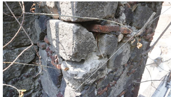
Figura 94. Estado inicial de Muro Norte.
