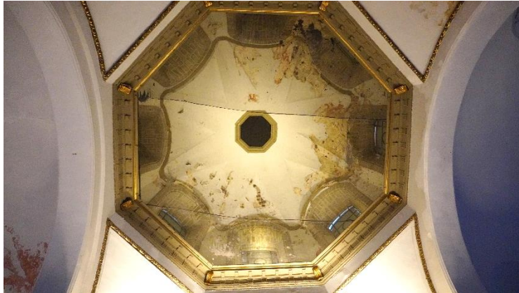
Figura 62. Estado inicial de intradós de Cúpula principal..
