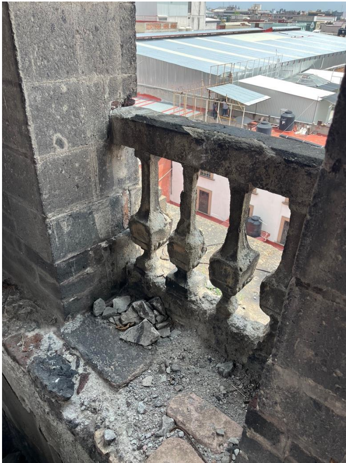
Figura 97. Estado de las bastradas
