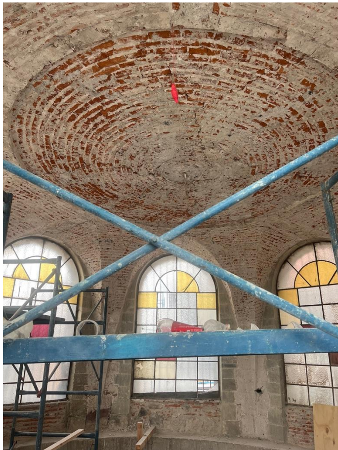
Figura 110. Retiro de aplados degradados en interior de tambor
