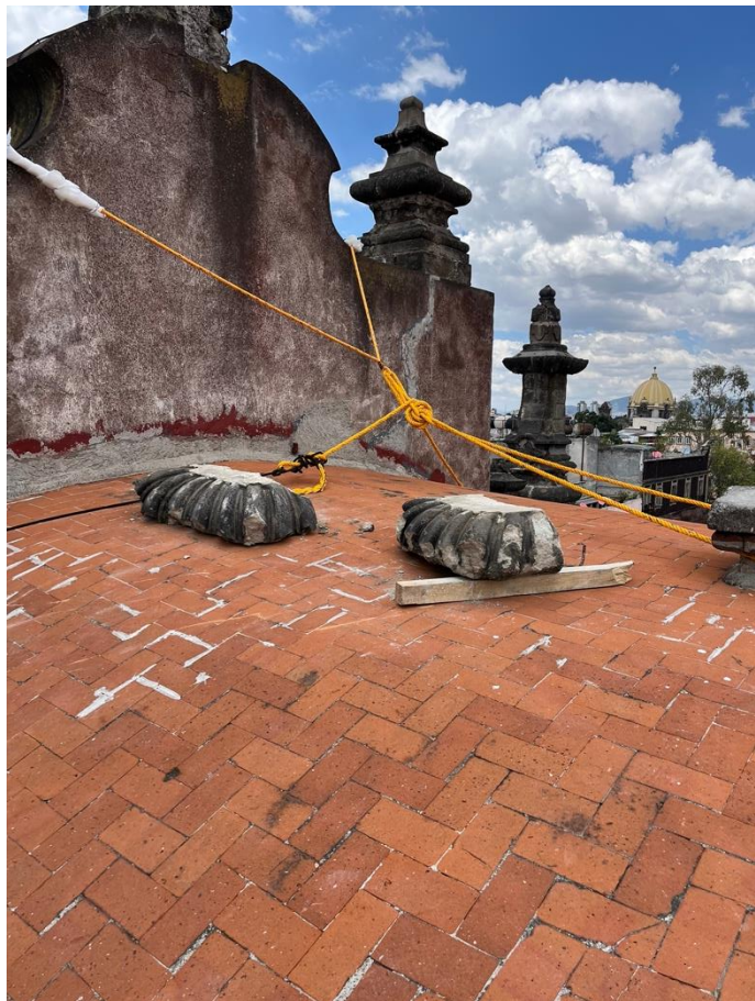
Figura 15. Estado del enladrillado en extradós de bóveda de coro
