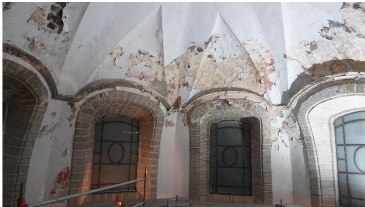
Figura 64. Estado inicial de intradós de Cúpula Principal. .
