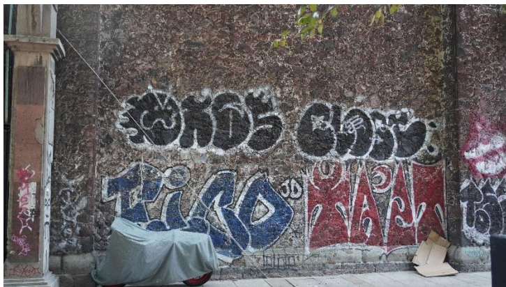
Figura 93. Estado inicial de Muro Norte.
