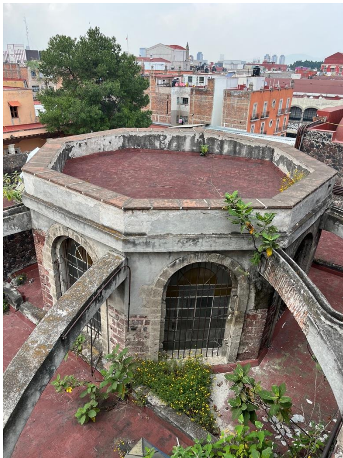
Figura 117. Estado del exterior del tambor
