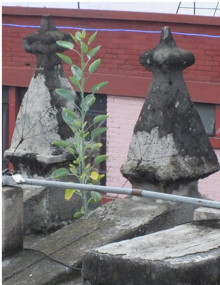
Figura 188. Estado de pináculos
