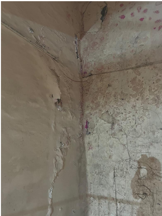
Figura 104. Estado de zona de coro
