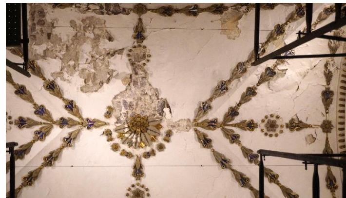
Figura 72 .Estado Inicial de intradós de bóveda en Capilla de Dolores.
