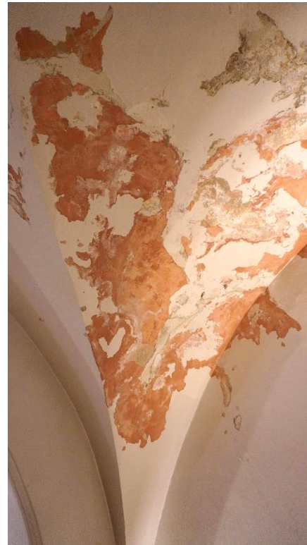
Figura 24. Estado inicial de intradós de bóvedas.
