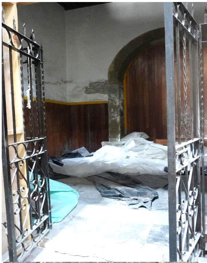
Figura 5. Estado de la capilla previo a intervención
