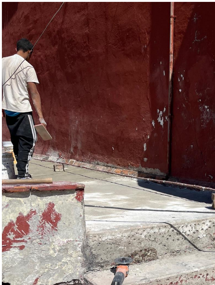
Figura 144. Estado de muro en fachada poniente
