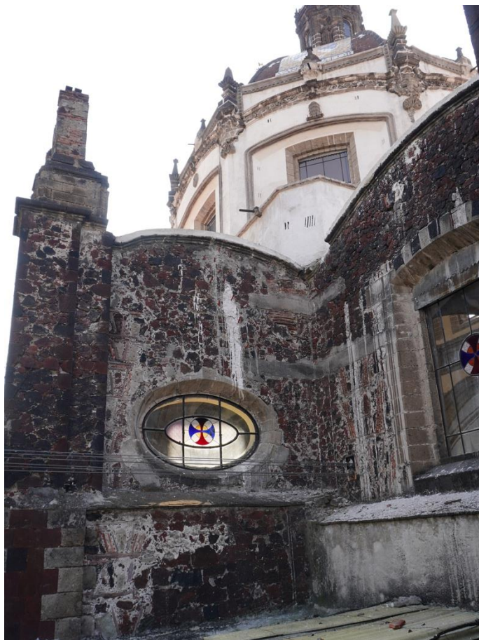
Figura 49. Estado de los paramentos en fachada norte
