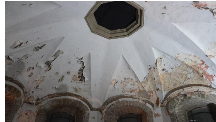
Figura 63. Estado inicial de intradós de Cúpula Principal.
