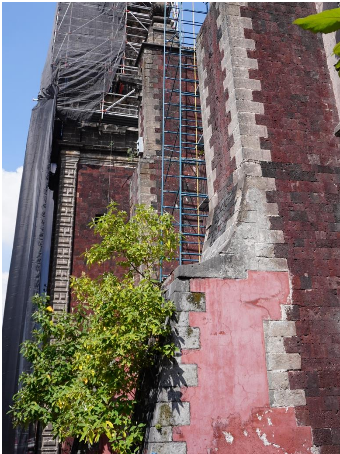
Figura 46. Estado de flora parásita en fachada sur
