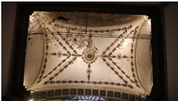
Figura 71 .Estado Inicial de intradós de bóveda en Capilla de Dolores.
