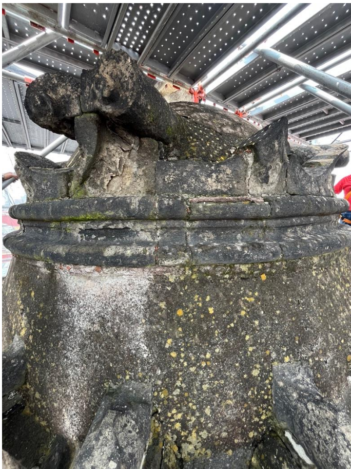
Figura 19. Estado de la corona en torre campanario
