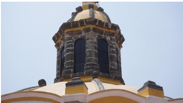
Figura 58. Estado final de Cupulín..
