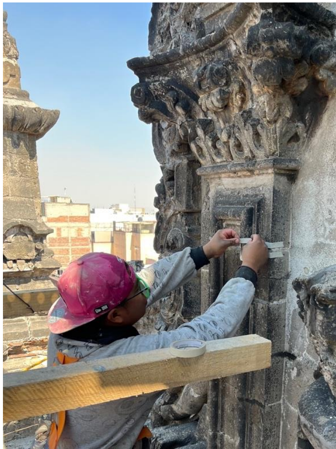
Figura 40. Estado de fachada antes de trabajos de rejunteo
