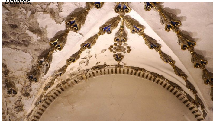
Figura 73 .Estado Inicial de intradós de bóveda en Capilla de Dolores.
