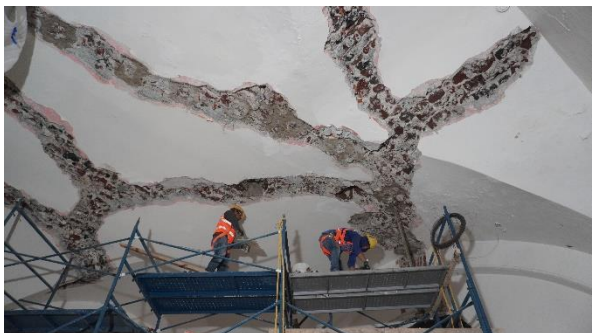
Figura 38. Repellido en trayectoria de grietas previamente consolidadas.
