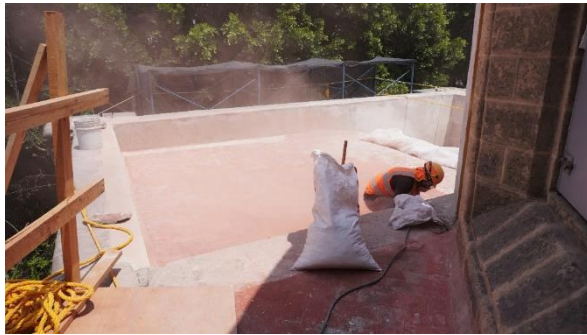
Figura 86. Liberación de impermeabilizante existente.
