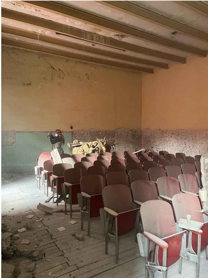
Figura 59. Estado del auditorio antes de intervenciones
