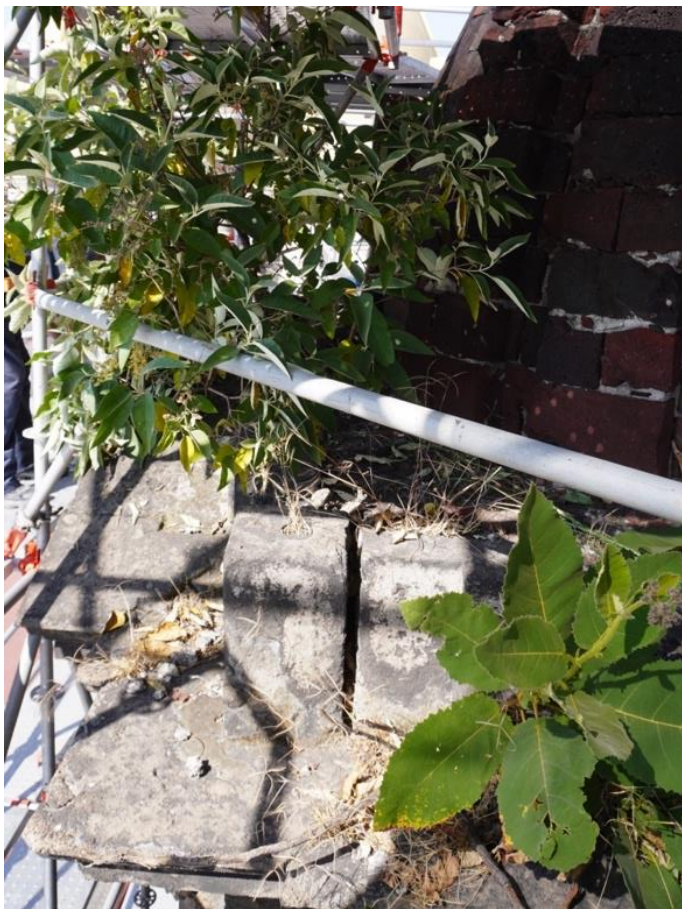
Figura 88. Estado de flora parásita en torres campanario
